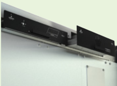
Monitoreo integrado de las baterías Alber BDSi para los gabinetes complementarios de baterías Liebert NXL
