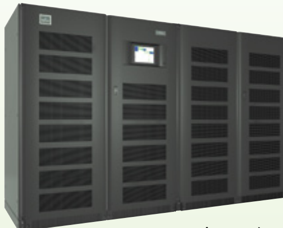
Liebert NXL (750 kVA)
